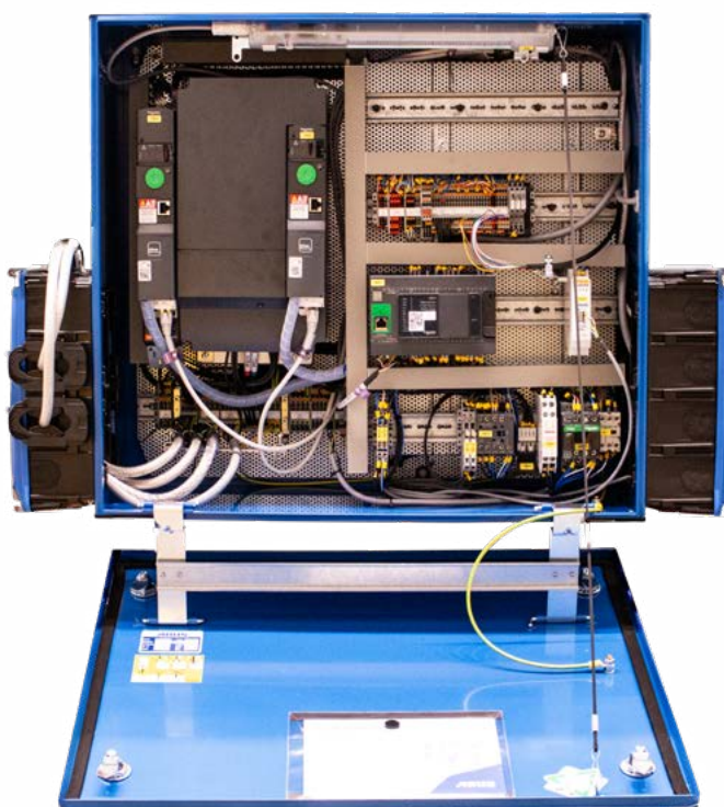
Coffret électrique équipé de composants standards
