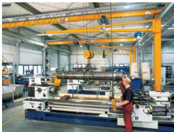
Equipement de machines d'usinage mécanique
